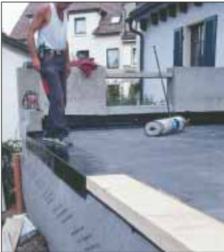
7. Grube deski stanowiące obramowanie uszczelnia się izolacyjnym pasem samoprzylepnym, aby brzegi wychodziły poza styk z płytą.
