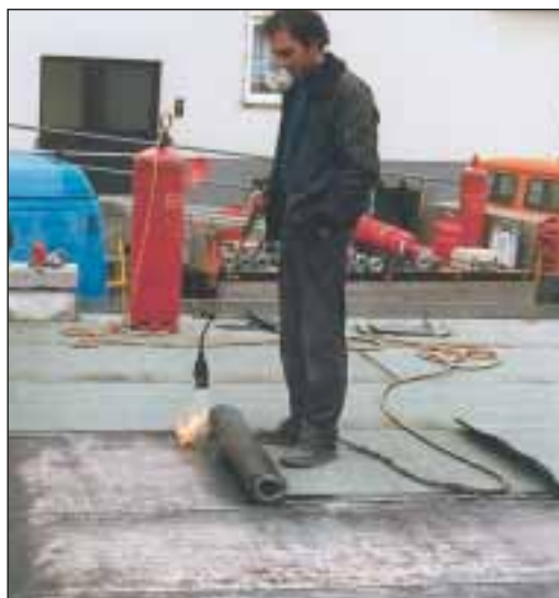
23. ... tarasu przykleja się już kolejną warstwę papy. Po nagraniu palnikiem docisnąć mocno nogą do podłoża. Poszczególne pasy mają zakładkę w kierunku wzdłużnym.
