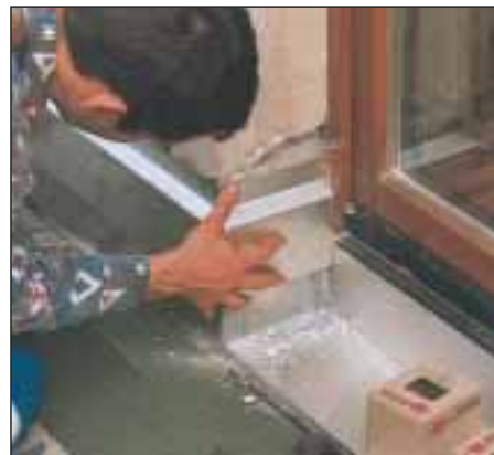
27. Szczególnie istotne jest równo wykonane przyłącze w obrębie drzwi tarasowych. Blacha dochodzi do ramy drzwiowej.
