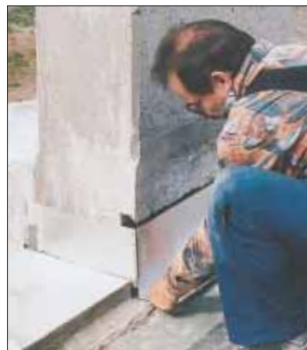
19. ... nie ma żadnego wgłębienia, trzeba było bardzo dokładnie wykonać obramowanie z blachy, aby szczelnie przylegało do słupka.
