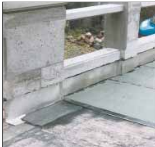
21. Po zalutowaniu blaszanych kątowników zakleja się je pasem uszczelniającym przylegającym ściśle do pierwszej warstwy izolacji. Potem nakłada się drugą, zieloną warstwę papy,
